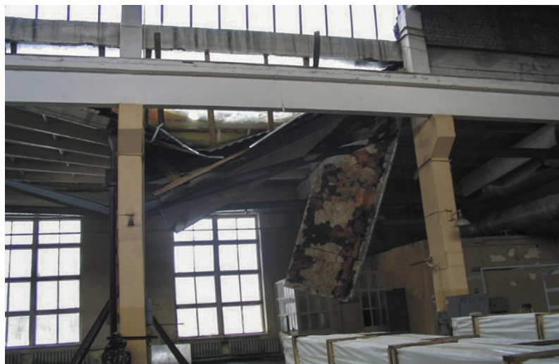
Рис. 1. Обрушение цеха в Екатеринбурге из-за разницы осадок фундаментов опорных колонн в 5 см (расчет осадок выполнялся по СНиП 2.02.01-83*)
