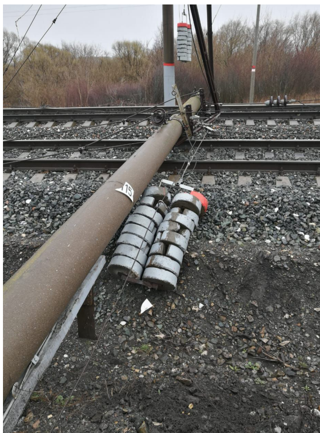
Рис. 1. Падение анкерной опоры вследствие электрической коррозии арматуры
