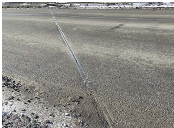
Рис. 1. Деформационный шов путепровода через объездную дорогу по ул. Щербакова
