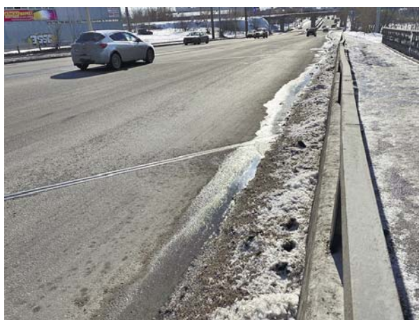
Рис. 3. Деформационный шов визуально прерывается под покрытием тротуаров
