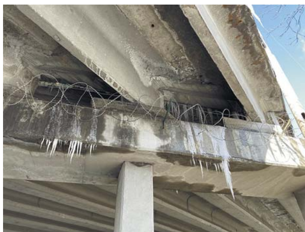
Рис. 2. Деформационный шов рассматриваемого путепровода. Вид снизу
