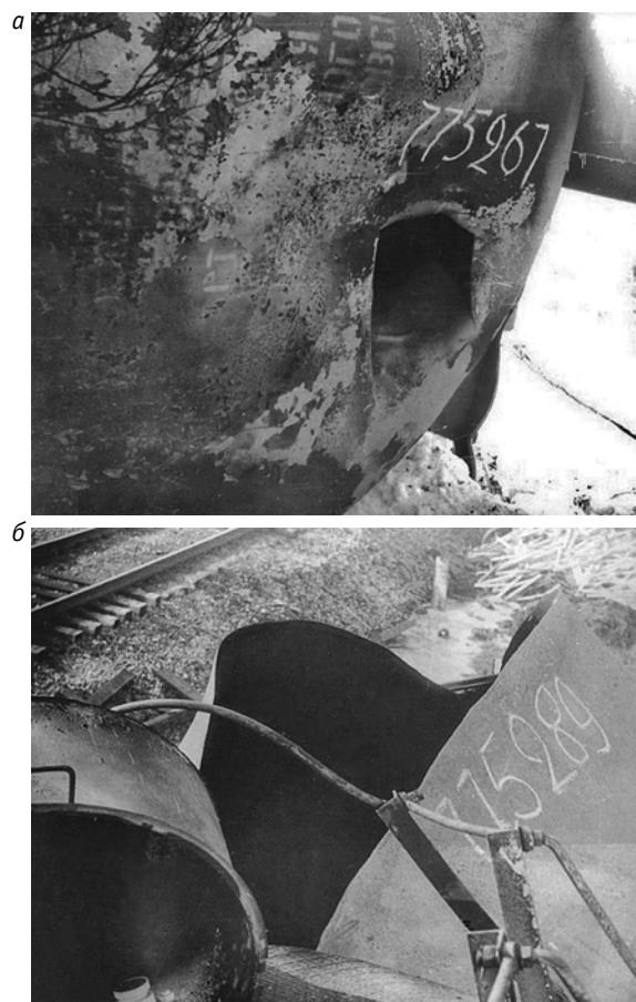
Рис. 1. Результаты аварийного режима: а — пробой днища котла автосцепной вагона; б — последствия пробоя днища
