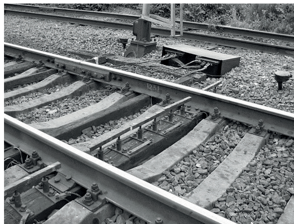
Рис. 3. Общий вид несущей платформы УКСПС в виде дополнительной деревянной шпалы, размещенной в межшпальном пространстве [1, 2]
