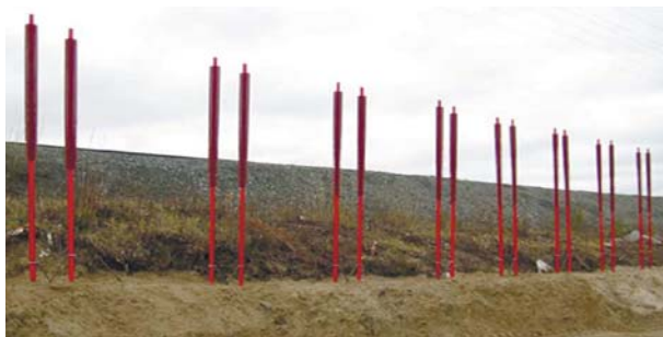
Рис. 4. Применение термосифонов на 489-м километре Коротчаевской дистанции пути Свердловской железной дороги
