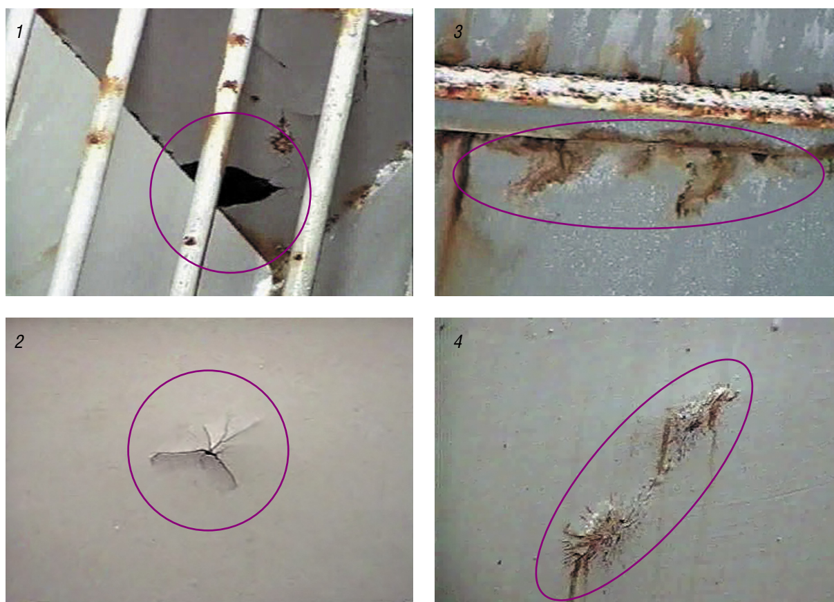
Рис. 1. Характерные разрушения защитных покрытий внутренних поверхностей вагонов для перевозки минеральных удобрений: 1 — отслоение защитного покрытия; 2 — вспучивание; 3 — растрескивание от обратного удара; 4 — повреждение от прямого удара и вспучивание
