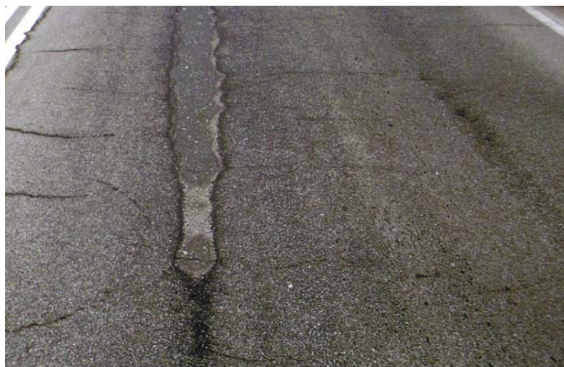
Рис. 5. Колея износа на автомобильной дороге Екатеринбург — Реж — Алапаевск. Участок дороги, на котором устроен слой износа по технологии «Новачип»
