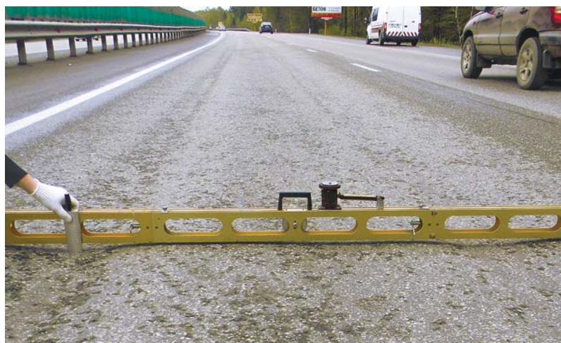
Рис. 1. Колея износа на левой полосе автомобильной дороги Екатеринбург — Тюмень после 4 лет эксплуатации
